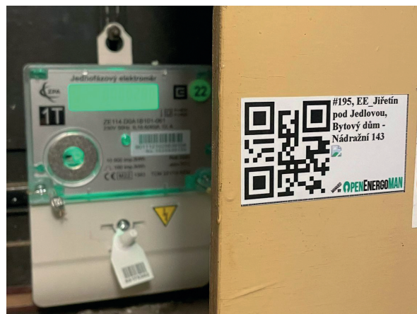
DSO Tolštejn – zjednodušení pro samoodečty v energetickém managementu: QR kód na štítku
