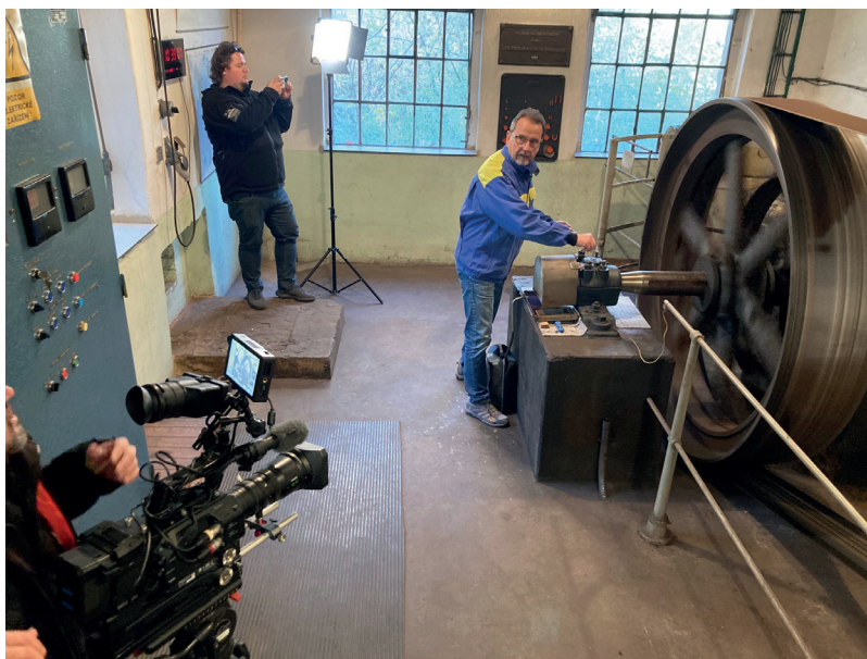
Malá vodní elektrárna Břehy (interiér při natáčení dokumentu)
