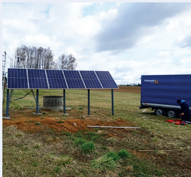
Obec Okrouhlice a její systém čerpání vody do kopce pomocí sluneční energie
